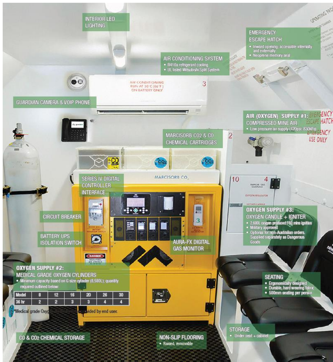
รูปที่ ๗ แสดงอุปกรณ์ภายในห้องนิรภัย
