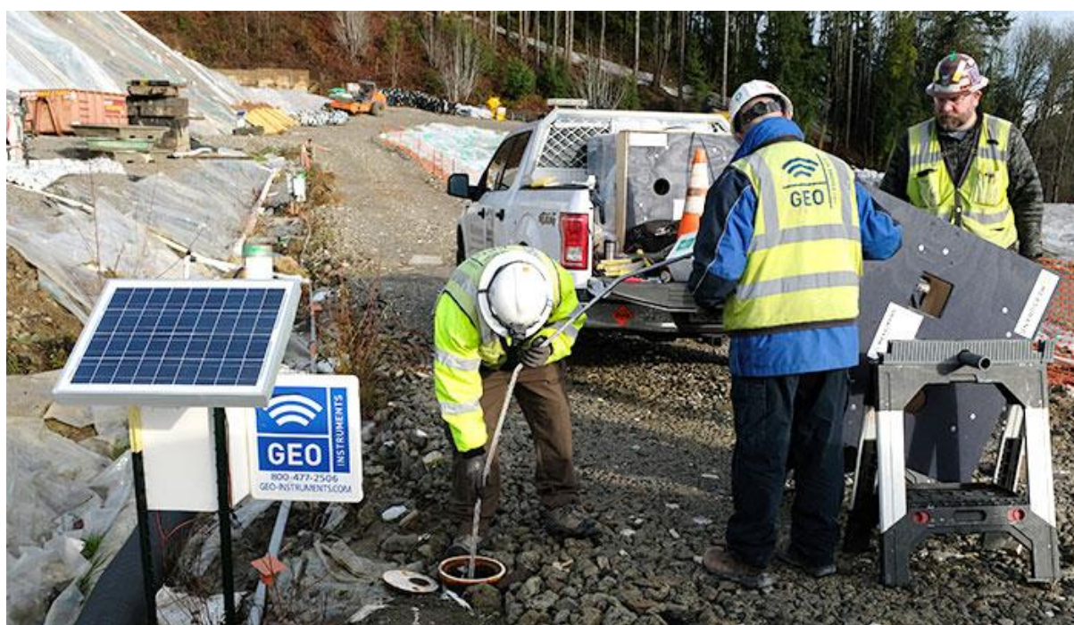
รูปที่ ๒ การติดตั้ง ShapeArray ในสถานที่จริง
