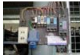
การปรับปรุงแผงสวิตซ์ไฟฟ้าให้ปลอดภัยต่อการใช้งาน
