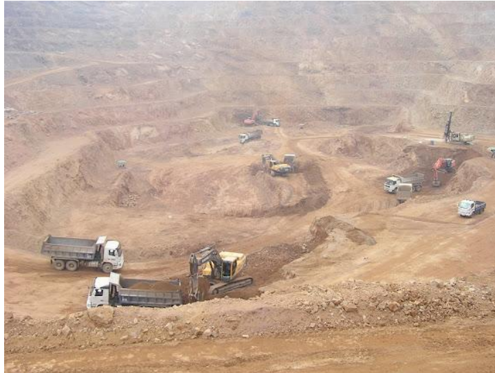
รูปที่ 6.4.1 ทำอัดระเบิดโดยไม่เคลื่อนย้ายคนงานและเครื่องจักรไปไว้ในที่ปลอดภัยเสียก่อน
