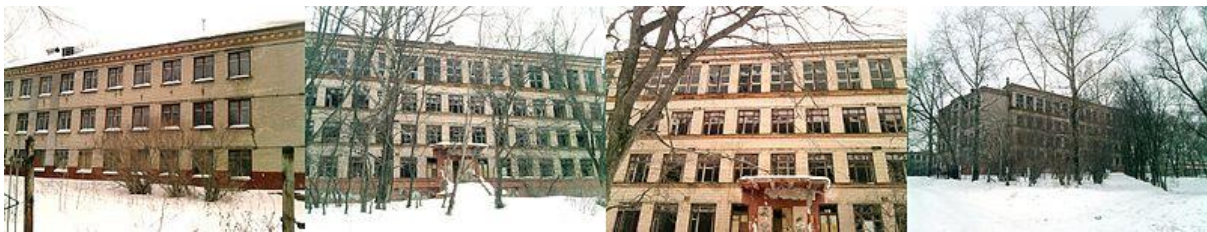
รูปที่ 7.6.11 สภาพอาคารโรงเรียนนานาชาติที่ถูกทิ้งร้างเนื่องจากการเคลื่อนย้ายคนออกไปเพราะอยู่ในพื้นที่ภัยพิบัติมองเห็นอาคารแตกร้างอยู่ทั่วไป (ที่มา: ru.wikipedia.org)
