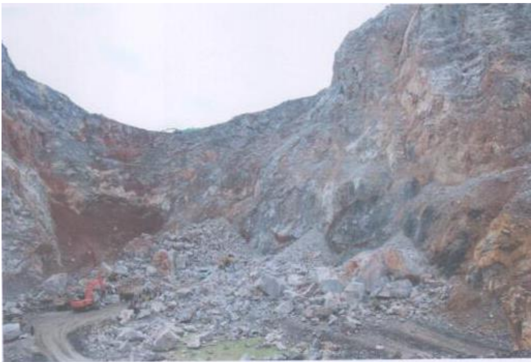
รูปที่ 7.4.6 ภาพหน้าเหมืองถล่มที่อำเภอเขาย้อย จังหวัดเพชรบุรี เมื่อวันที่ 3 มิถุนายน 2556
