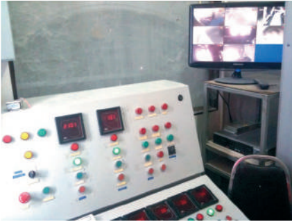
มีการใช้ CCTV ในการตรวจดูการทำงานของเครื่องจักร
